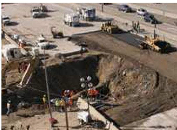
Figura 1.1. Rompimento de uma adutora em Denver.
