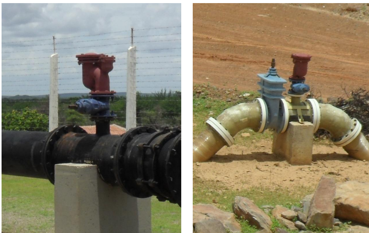
Figura 3.10. Ventosas de Tríplice Função com válvula de seccionamento para manutenção. Fonte: autor.
