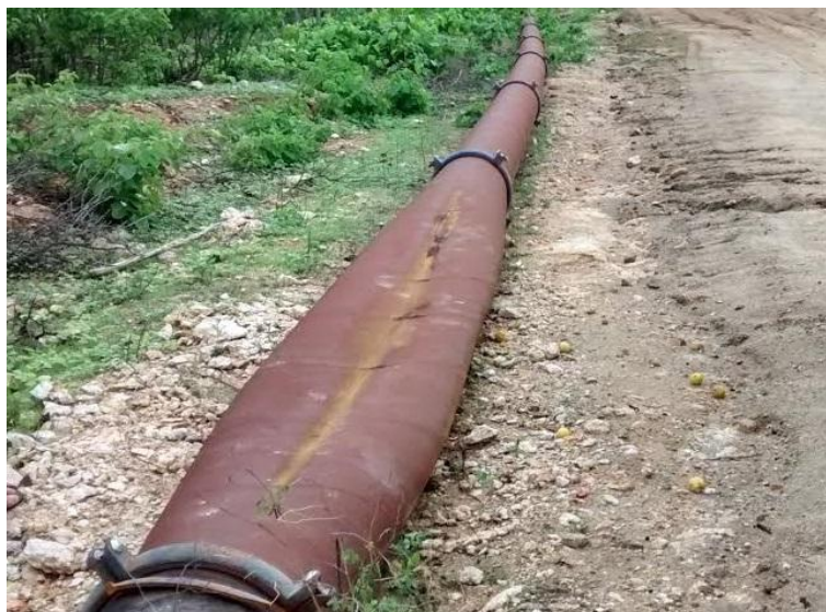
Figura 1.3. Colapso da Adutora de General Sampaio no Ceará. Fonte: Engenheiro Elias Teixeira, em Canindé Notícias, 2016
