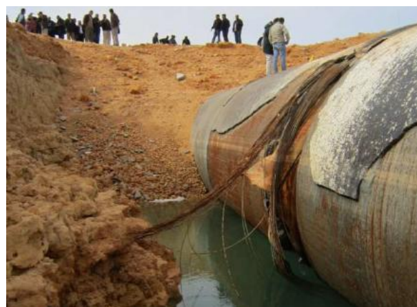
Figura 1.2. Rompimento de um conduto forçado na Líbia.
