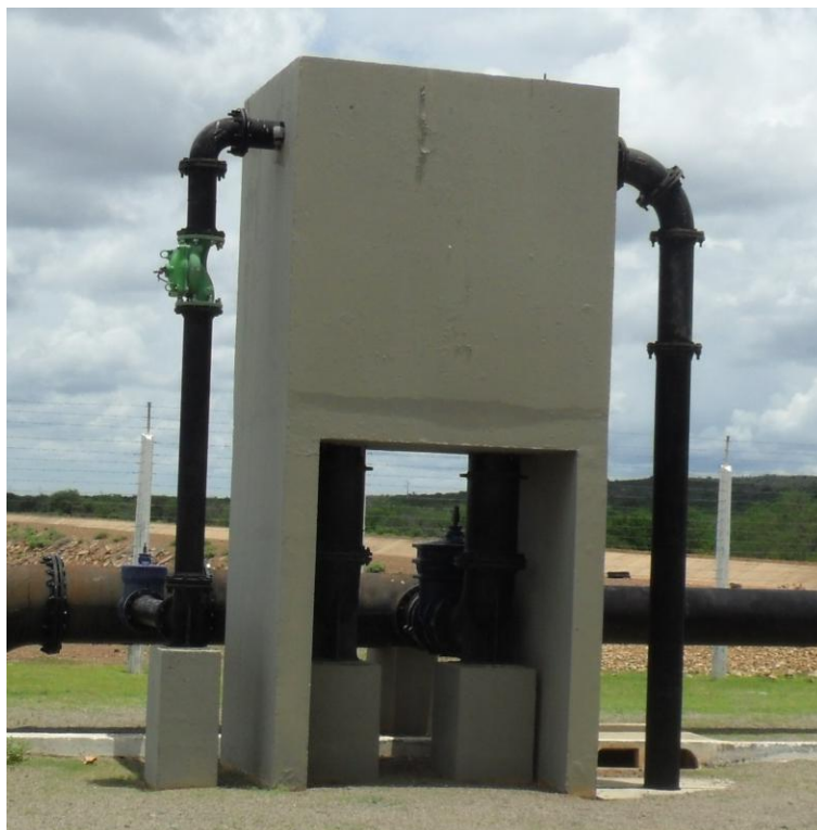
Figura 3.2. Tanque de Alimentação Unidirecional (TAU) logo a jusante de uma estação de bombeamento.
