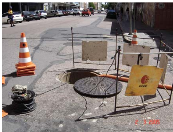
Figura 3: Caixa de inspeção em rede de distribuição subterrânea.
