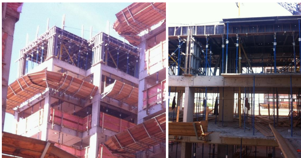
Figura 13. Execução de tarefas em altura sem SPP.
