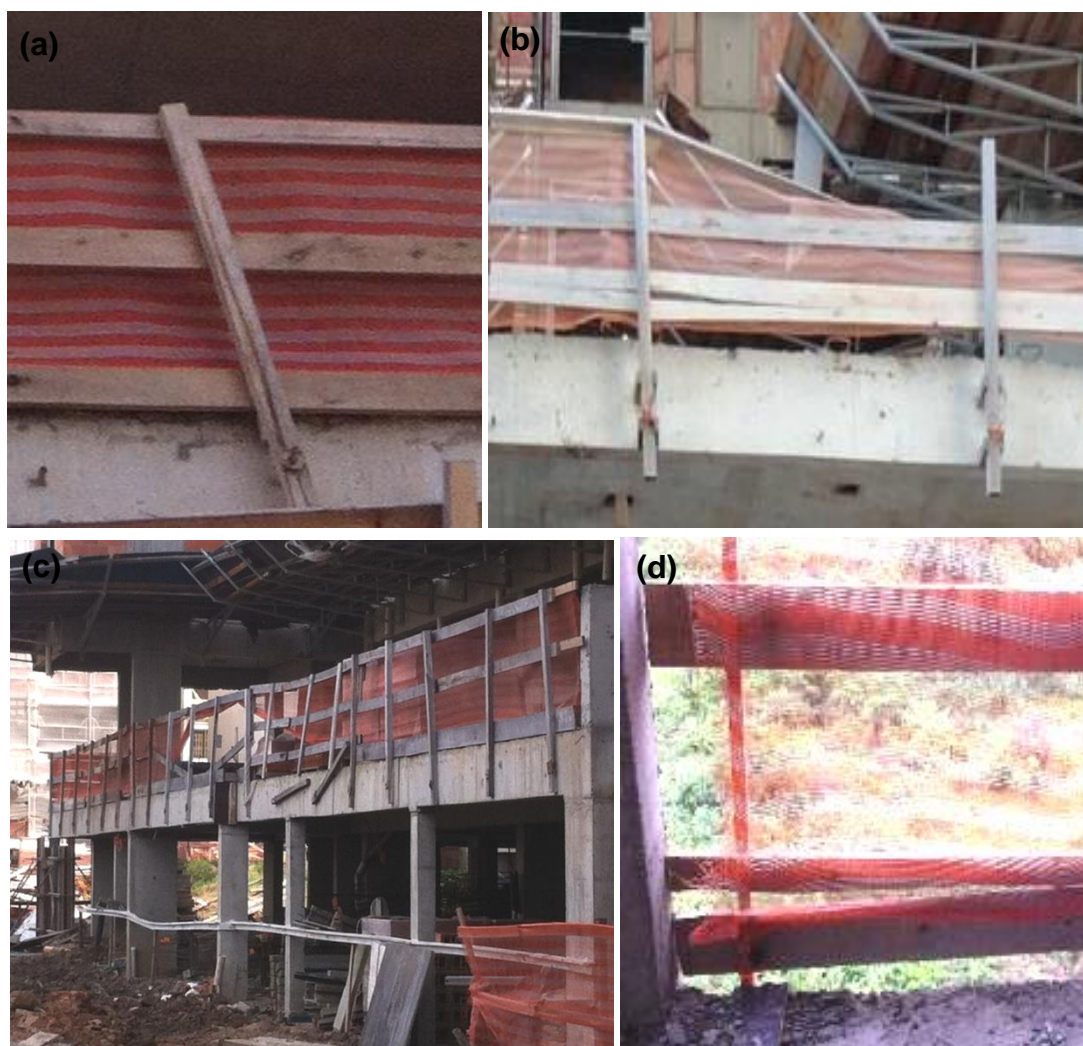
Figura 11. SPP-MA: (a) rachadura no montante e perda da estabilidade; (b) rachaduras no rodapé e desprendimento do travessão superior e tela; (c) deslocamento de montantes e desprendimento de travessões intermediários; SPP-MI: (d) abertura no rodapé.
