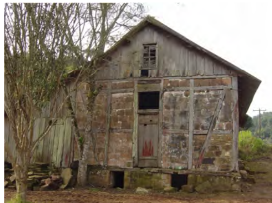
Imagem 92: Detalhe da estrutura enxaimel mista do Armazém e Salão de Baile Müller na Localidade Linha Boêmia. Fonte: Fotografia do autor (2013).
