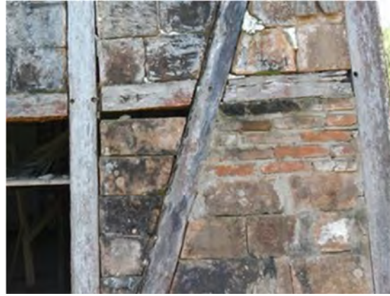
Imagem 94: Detalhe da estrutura enxaimel mista do Armazém Müller na Localidade Linha Boêmia. Fonte: Fotografia do autor (2013).
