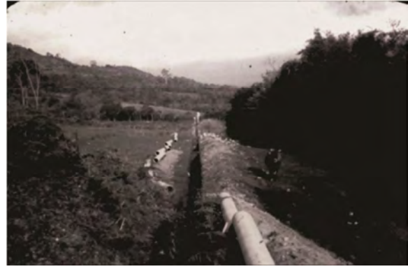
Imagem 175: Imagem da instalação de infraestrutura para a sede. (sem data). Fonte: DVD 520 Fotos Antigas de Agudo/RS , de autoria de Tilo Hentschke, Digitalização: Erni Böck Produções.
