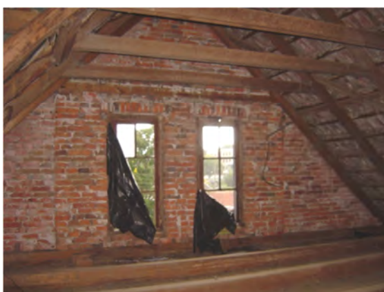
Imagem 103: Interior do sótão do antigo comércio Treptow, mostrando um estado de conservação mediano, mas em degradação. Fonte: Fotografia do autor (2009).
