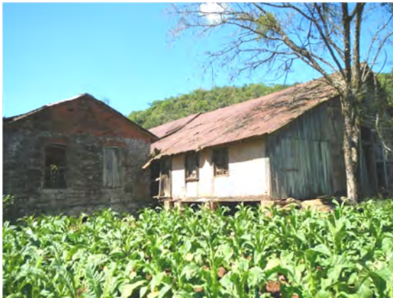
Imagem 83: Armazém Müller (Linha Boêmia) com partes do enxaimel comprometidas. Fonte: Fotografia do autor (2009).
