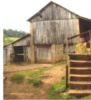
Imagem 114: Edificação no interior do município estruturada com pilares de pedra arenito. Fonte: Fotografia do autor (2009).
