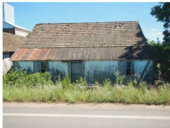
Imagem 219: Conjunto enxaimel em estado de arruinação no interior do município. Fonte: Fotografia do autor (2013).
