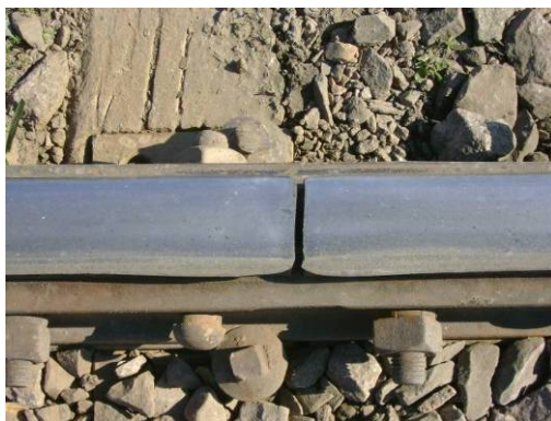
Figura 11 – Pequeno espaço deixado entre dois trilhos consecutivos, devido à dilatação térmica.
