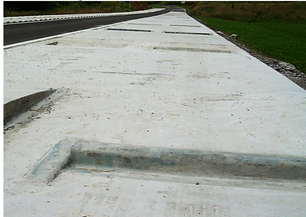
Figura 40 - Pista de teste: Buracos
