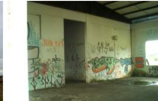
Foto 27 - Pavilhão construído recentemente e atualmente abandonado e depredado
