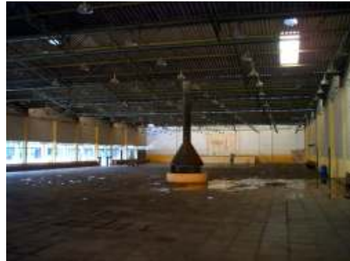
Foto 21 - Vista geral do espaço para evento com uma das duas lareiras no centro
