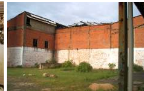
Situação de atual de abandono, 2009
