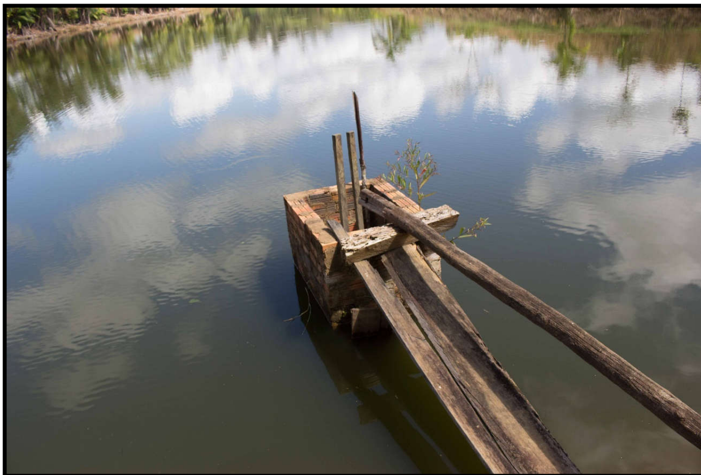
Foto 46 – Monge de fabricação própria em tanque escavado em piscicultura de pequeno porte.
