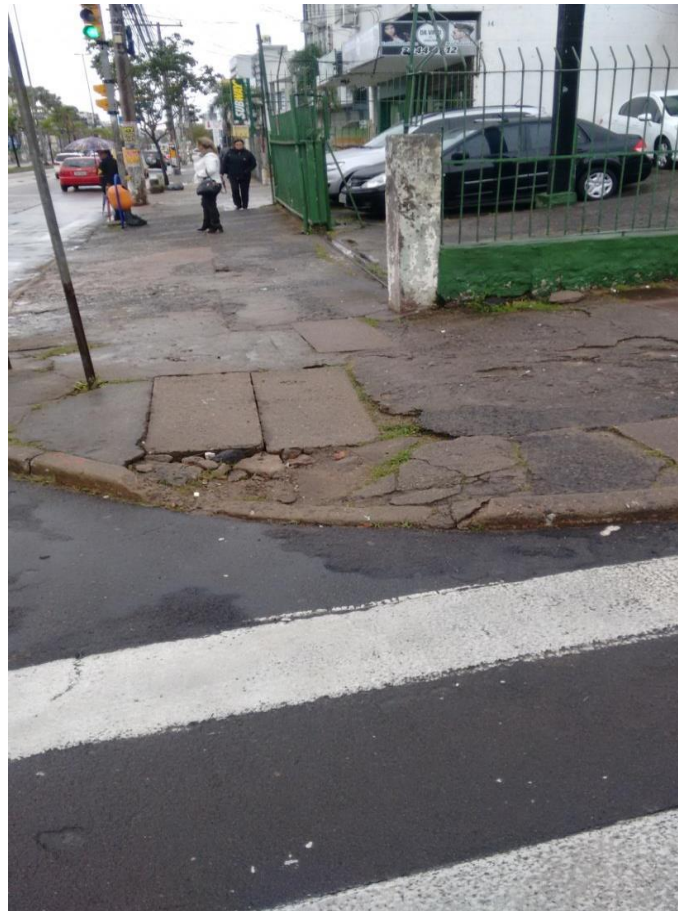
Figura 33 - Esquina Rua Dom Diogo de Souza
