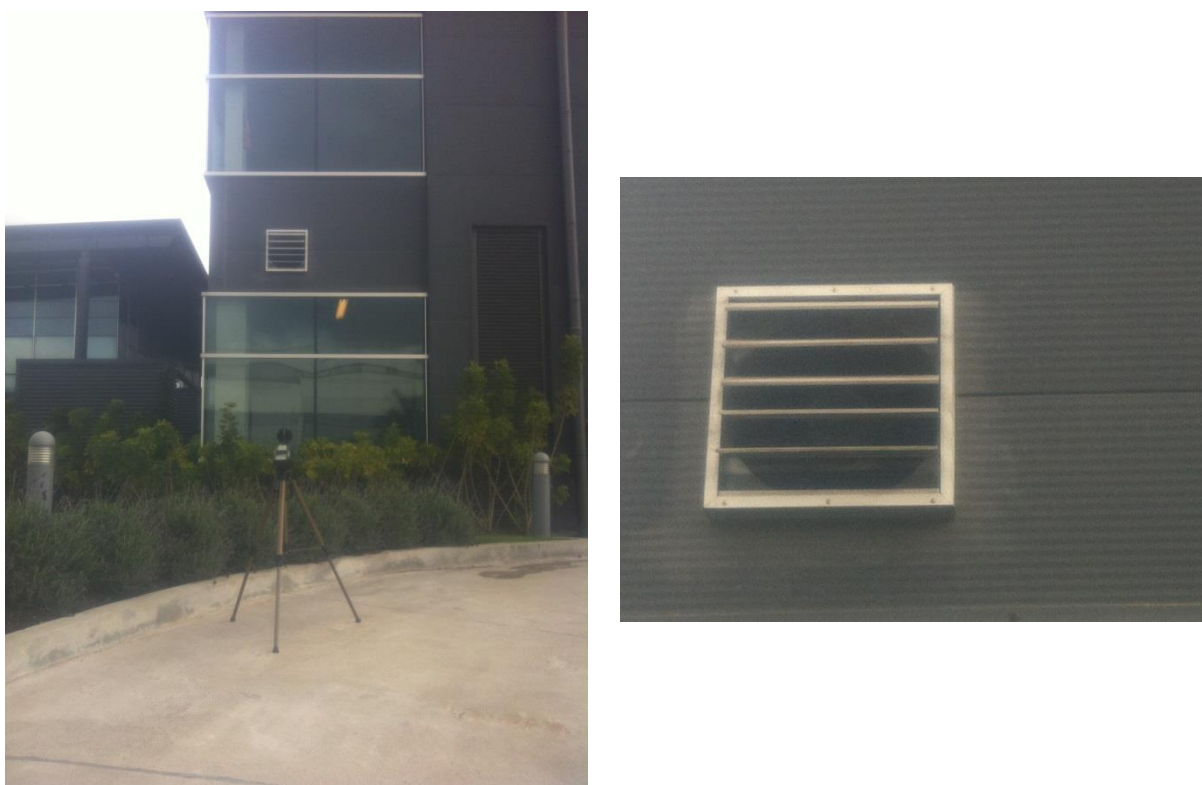
Figura 6.38 Fotografías del extractor de aire en el sector de mantenimiento en el momento de la toma de mediciones en el punto EX-MANT
