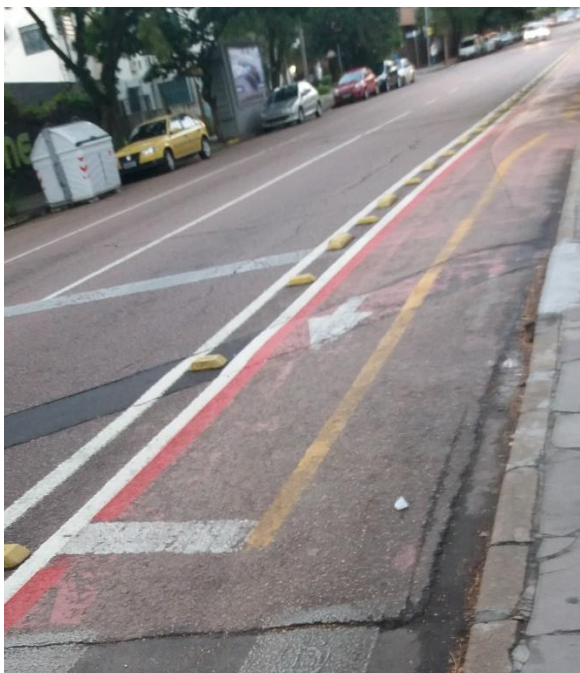
Figura 72 – Desgaste na pintura das setas de aproximação
