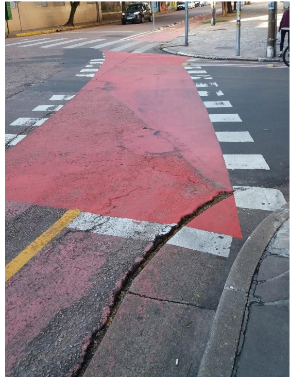
Figura 55 – Fissura na aproximação da interseção
