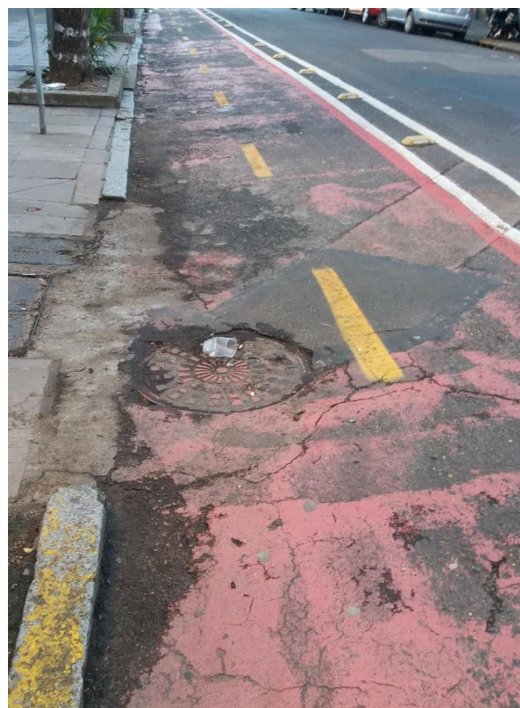
Figura 94 – Desníveis e fissuras no pavimento
