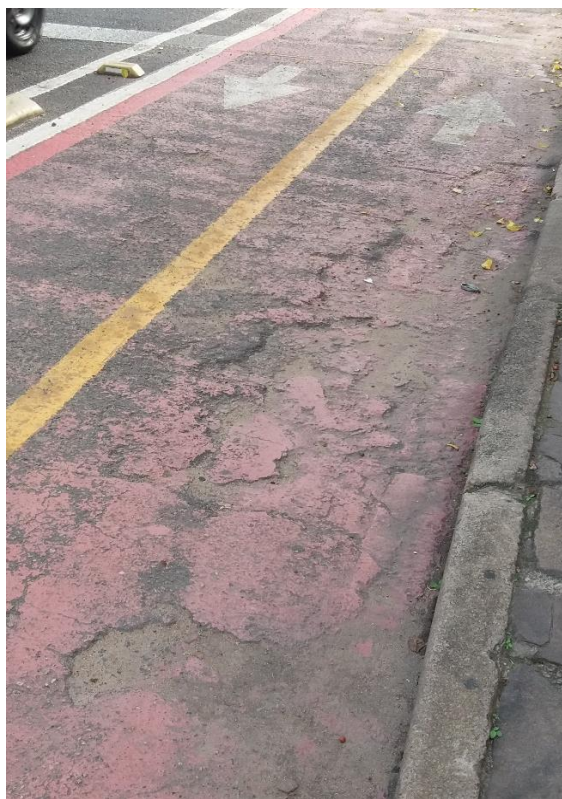
Figura 19 – Porção da ciclofaixa com desníveis e fissuras no pavimento
