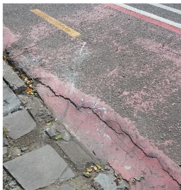
Figura 26 – Desnível junto ao meio-fio
