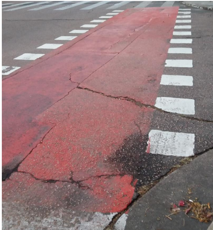
Figura 71 – Situação do pavimento
