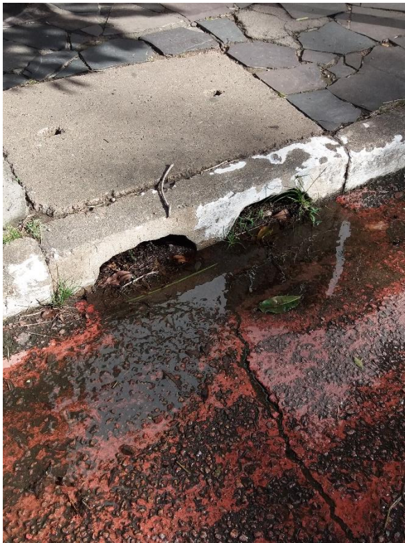
Figura 36 – Bueiro com resíduos
