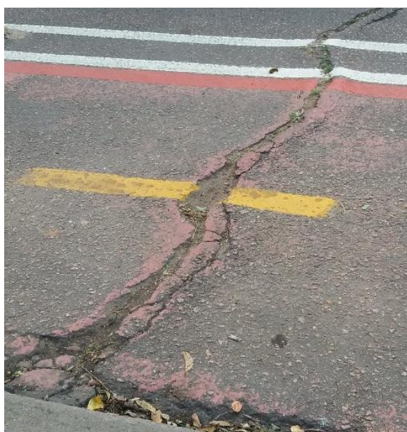
Figura 25 – Grande fissura no meio da faixa
