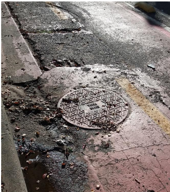
Figura 59 – Ponto com desnível no pavimento
