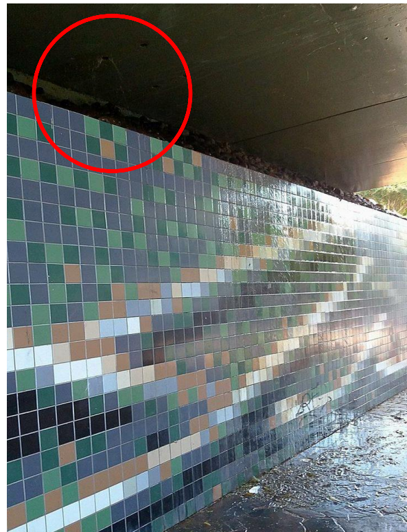
Figura 35 – Vazamento localizado no viaduto
