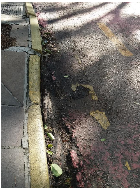
Figura 52 – Buraco junto ao meio-fio
