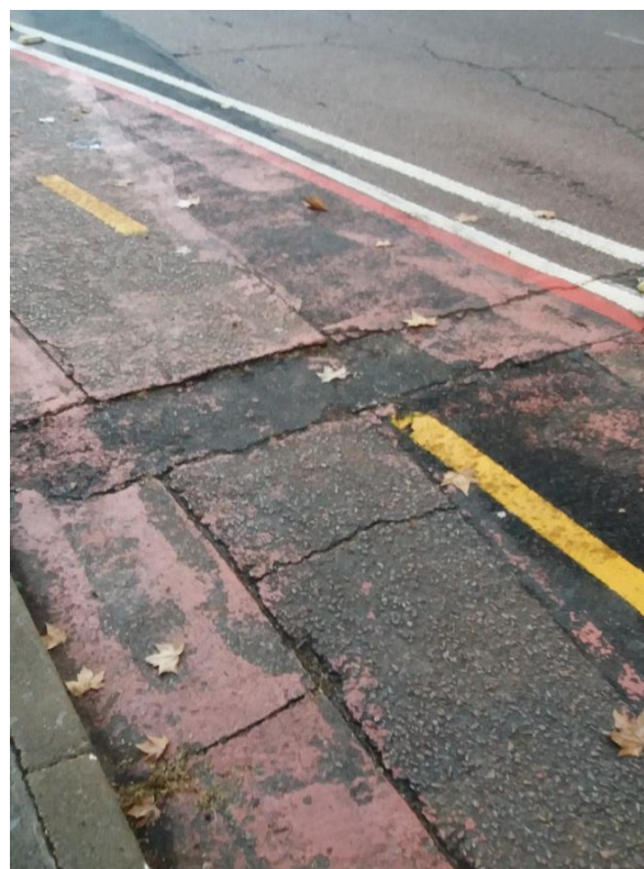
Figura 75 – Falhas no pavimento
