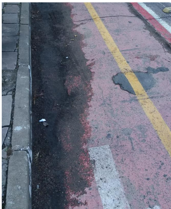
Figura 48 – Falha no pavimento junto ao meio-fio e no eixo central
