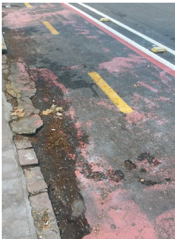
Figura 93 – Falhas acentuadas no pavimento
