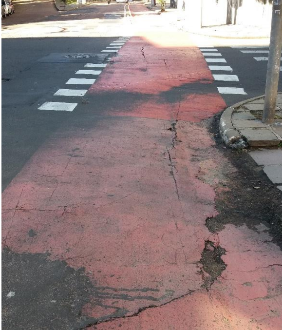
Figura 43 – Aproximação da interseção com problemas no pavimento e de pintura
