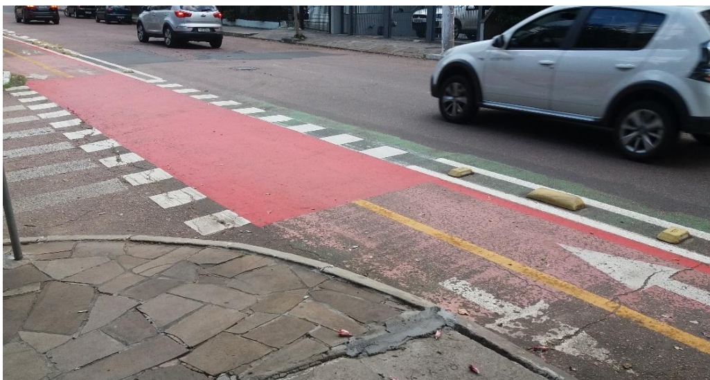
Figura 33 – Setas direcionais pintadas no pavimento apresentam desgaste
