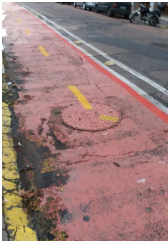
Figura 77 – Uma das falhas apresentadas pelo pavimento
