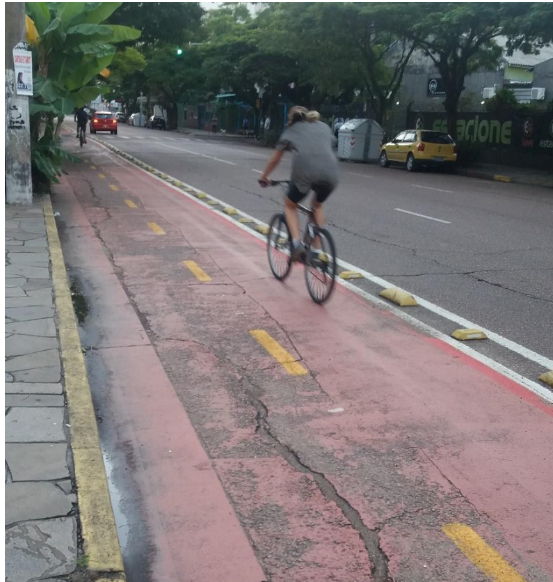
Figura 68 – Parte do trecho com algumas fissuras
