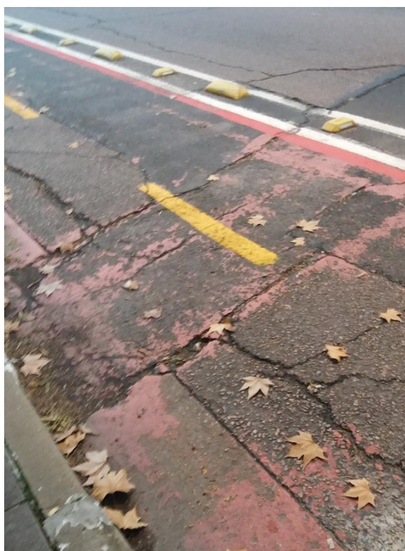
Figura 74 – Falhas no pavimento
