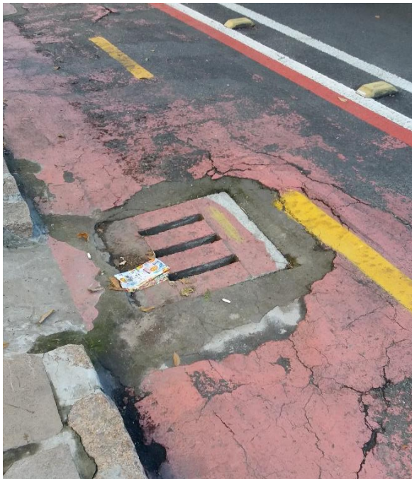
Figura 85 – Desnível junto ao bueiro
