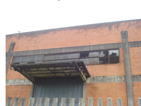
Edificação em estado de abandono
