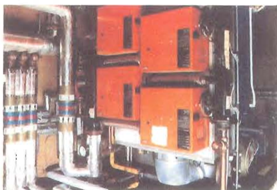
Figura 6 - The Cournaught Hotel, Bournemouth, UK. Sistema de aquecimento de energia com caldeiras modulares completam a unidade CHP (BRECSU, mar. 1996)
