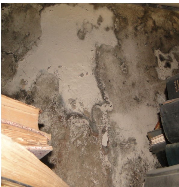
Figura 7 - Detalhes dos fungos e do mofo nas paredes próximo das encadernações
