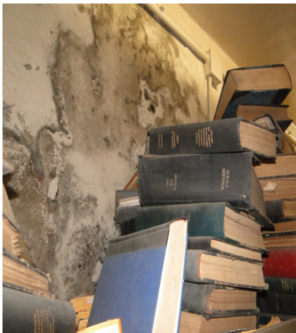
Figura 6 - Presença de mofo nas paredes da sala
