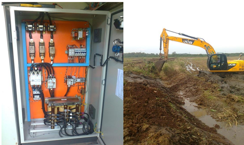
Figura 74 - Quadro de Comando do Sistema de Irrigação e Limpeza do Condutor de Água para as Lavouras
