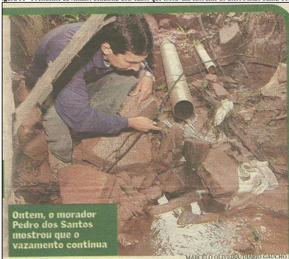
Figura 51 - Presidente da Amalst denuncia dois canos que escoavam chorume do aterro/lixão Santa Tecla
