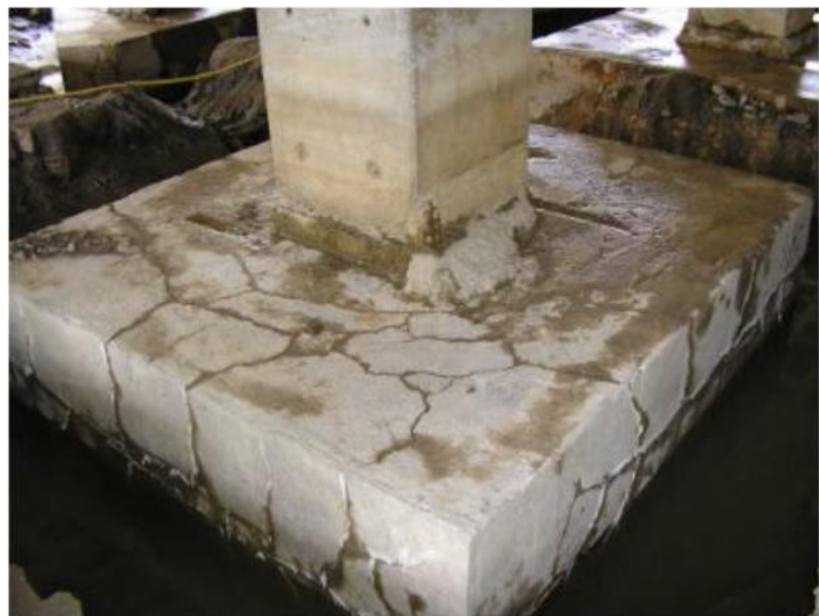
Figura 3.9: bloco de fundações afetado por reações álcali agregado. (NOGUEIRA, 2010)
