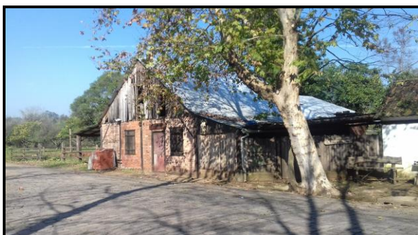
CTG Vista lateral
