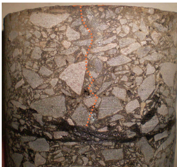
Figura 6.18 – Trincamento iniciando na base do recapeamento
