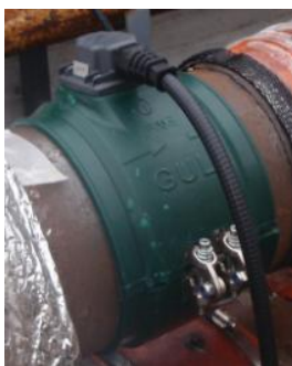
Figura 15 – Sistema de monitoramento por ondas guiadas da empresa GUL instalado em um riser rígido
