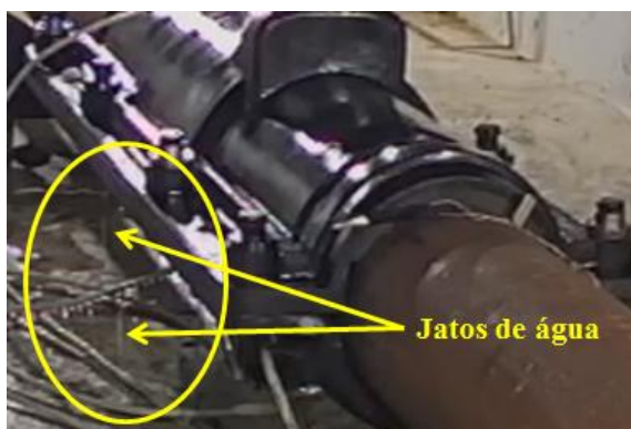
Figura 93 – Imagem da câmera de vídeo no momento que aumenta o vazamento na forma de jato de água
