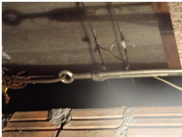
Fotografia 25: Reparo improvisado por morador da Rua Luiz Gautério
