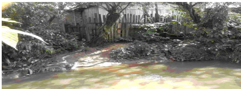
Figura 6: Ocupação irregular de moradias- (Vila Vera Cruz). Destruição da mata ciliar, com suscetibilidade à erosão pluvial e solapamento das margens. Foto: Gérson Brezola, 2017.
