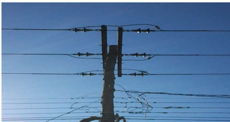
Figura 14 - Rede de distribuição existente da SE 'A'.
