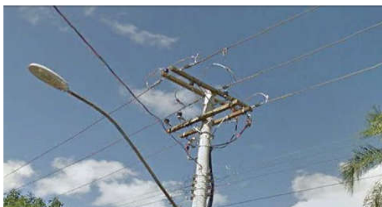
Figura 18 - Novo poste de derivação da rede de média tensão.
