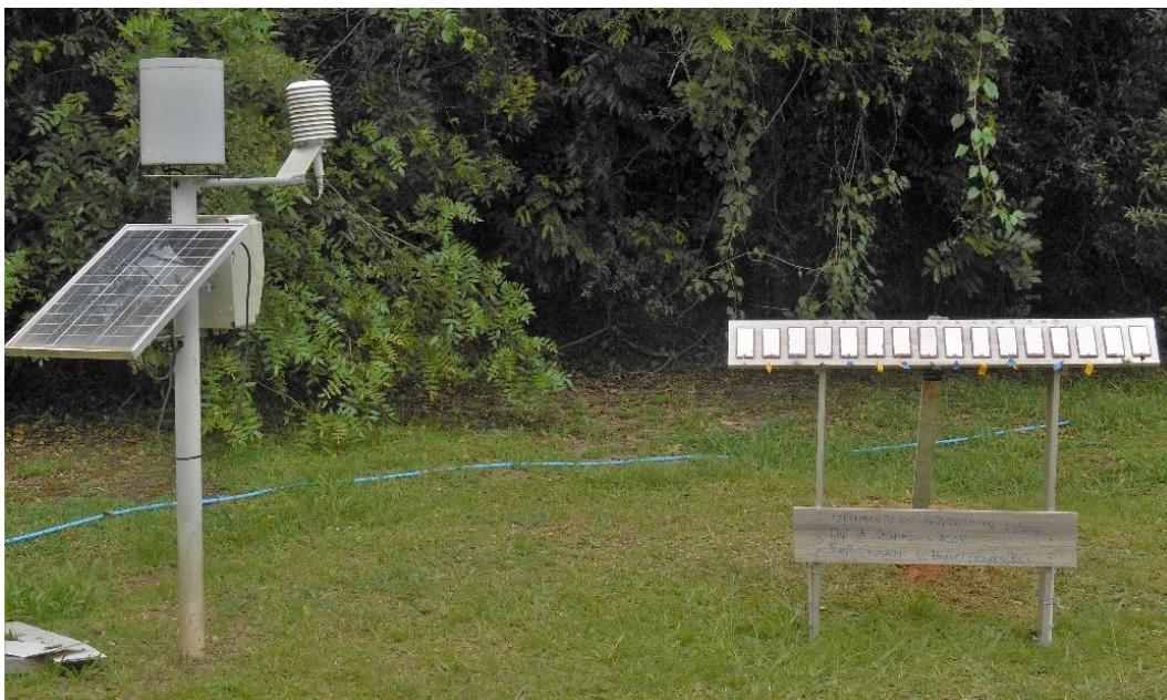
Figura 17 – Posição da estrutura ao lado do equipamento de monitoramento do centro de meteorologia da UFRGS.
