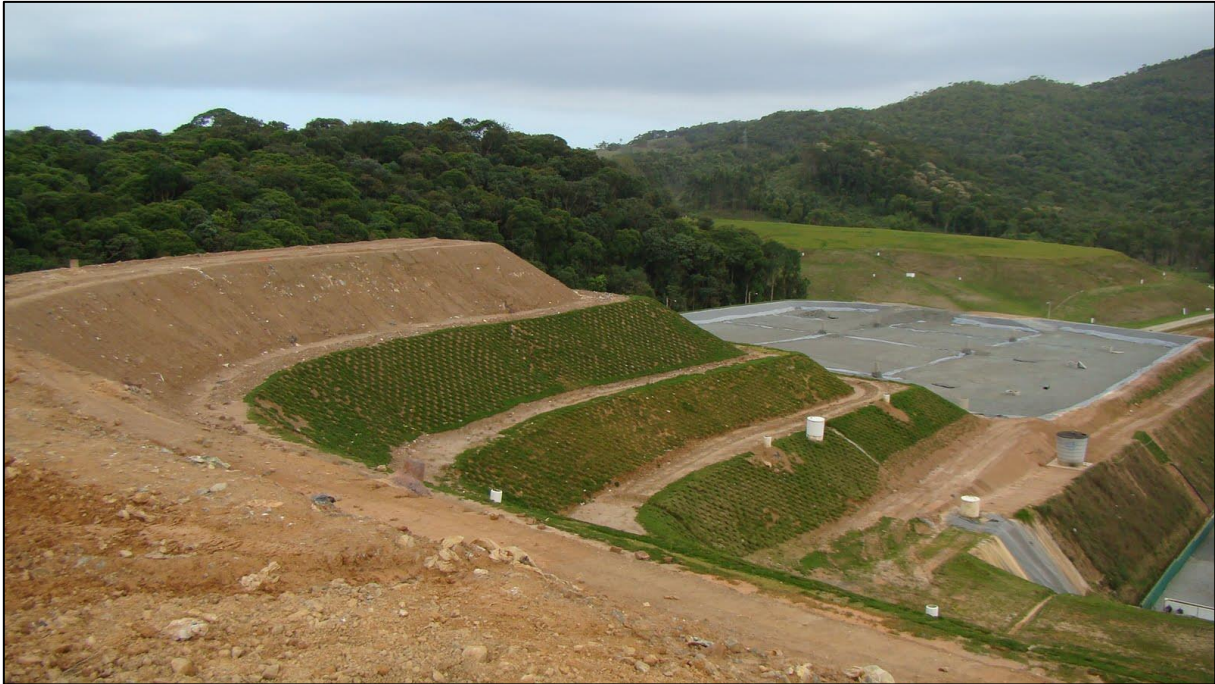
Figura 11: Aterro em meia encosta em Itajaí/SC. Fonte: http://geoconceicao.blogspot.com.br/ .
