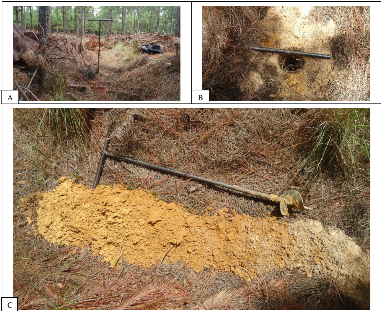
Figura 89: Foto A: local da sondagem; foto B: Furo S03; foto C: perfil de solo na área da sondagem S03. Fonte: Levantamento de Campo, 2018.
