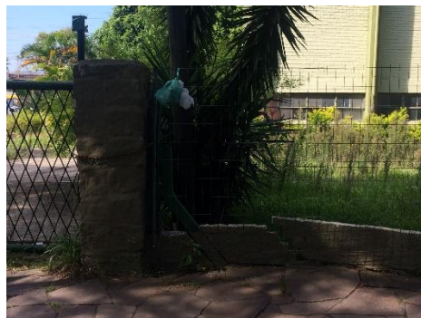
Figura 33 – muro do perímetro danificado
