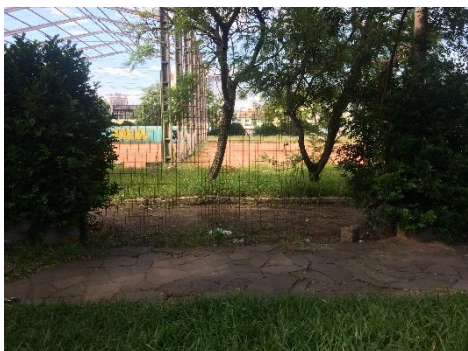
Figura 32 – cerca do perímetro danificada
