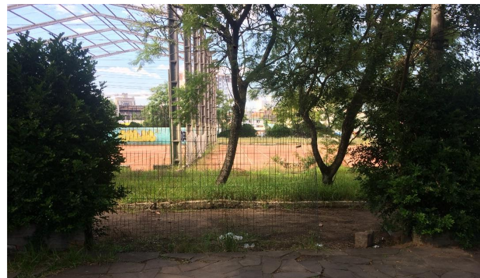
Figura 06 – cerca do perímetro do ginásio arrombada, sensação de insegurança dos moradores
