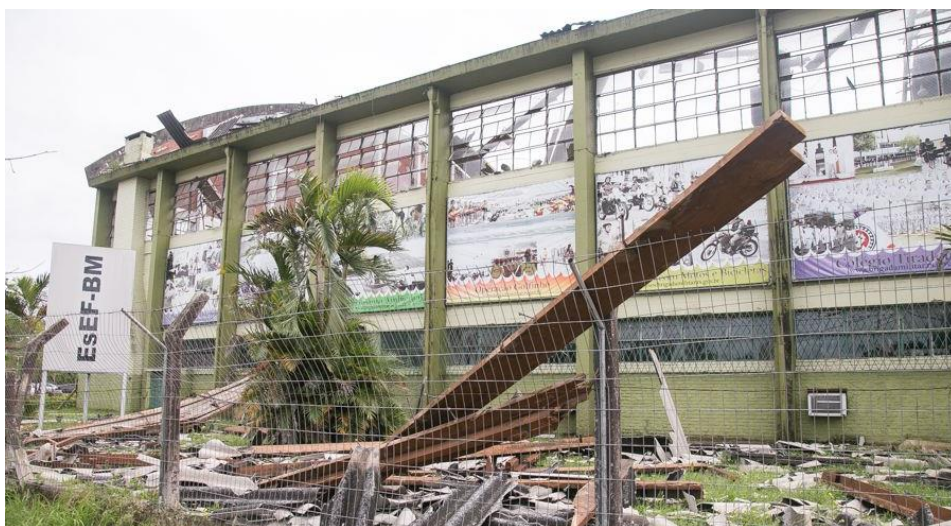
Figura 04 – segundo o morador Douglas, o abandono e descaso geram insegurança e provocam saques realizados por andarilhos e marginais
