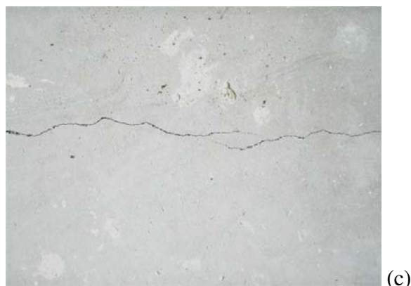
Figura 4: exemplos do mau uso do reescoramento. (a) escoramento no meio do vão da laje (TECHNE, 2005). (b) fissura devida à formação de um momento fletor negativo por conta de um reescoramento mal executado. (c) fissura, ainda não tratada, decorrente do momento negativo.
