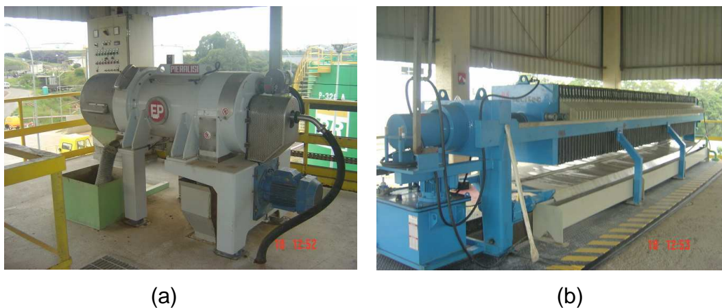
Figura 2.5 – a) centrífuga e b) filtro-prensa para separação do lodo dos tanques de sedimentação 11
