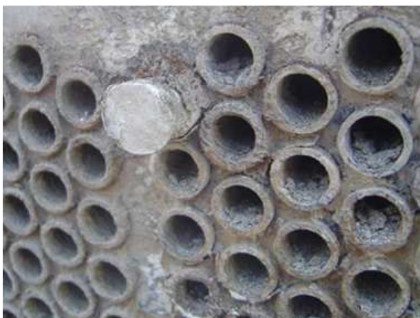
Figura 4.29 – Depósitos internos no permutador de calor M-709 em 2006.
