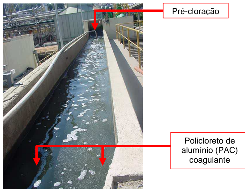
Figura 2.2 – Pontos de adição de cloro, dióxido de cloro na cloração e policloreto de alumínio (PAC) na ETA I para a coagulação. 10
