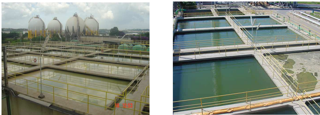
Figura 2.4 – Tanques de sedimentação das ETAs I e II da RECAP 10
