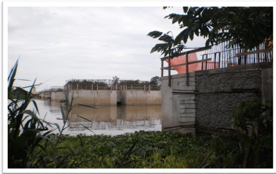
Fotografia 8 - Pilares da nova ponte próximos da terra da Ilha Grande dos Marinheiros
