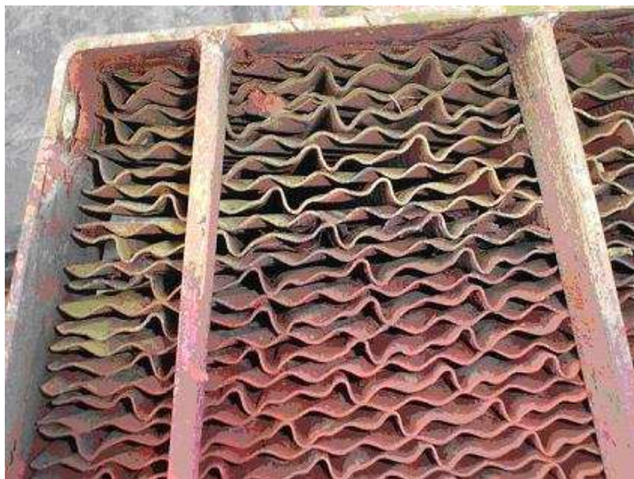
Figura 6.14- Cesto com depósitos de óxidos de enxofre nas chapas superiores de aço corrugadas revestidas com \text{Nb}_2\text{O}_5 , inspeção em dezembro de 2005 (REDUC, 2005).
