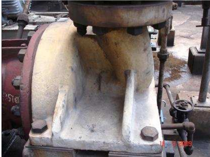
Figura 6.26- Bomba revestida com tinta epóxi pigmentada com Nb_2O_5 , inspeção em março de 2009 (Autoria da Foto de Marcelo Schultz).
