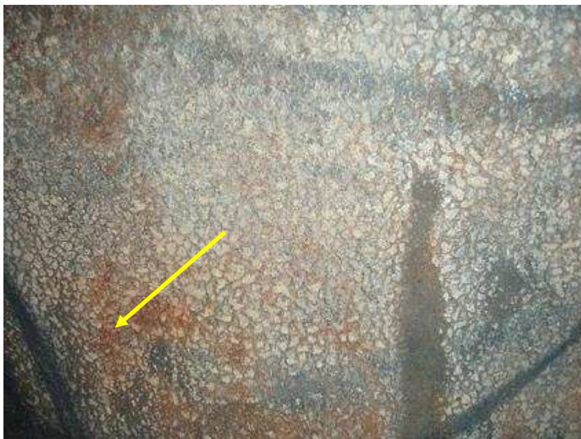
Figura 6.7 - Detalhe do revestimento de Nb_2O_5 , inspeção em 31/10/2007 (REDUC, 2007).
