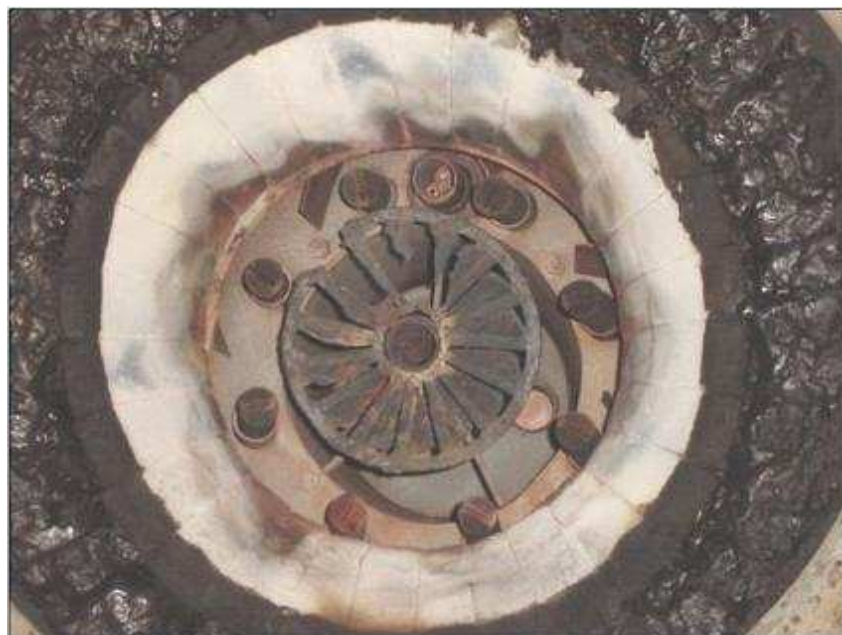
Figura 6.17- Difusor de ar não-revestido com corrosão generalizada e com perda de espessura, inspeção em maio de 2003 (REDUC 2003).
