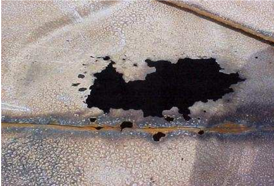
Figura 6.19- Chapa do teto do reservatório perfurada (SCHULTZ, 2003).
