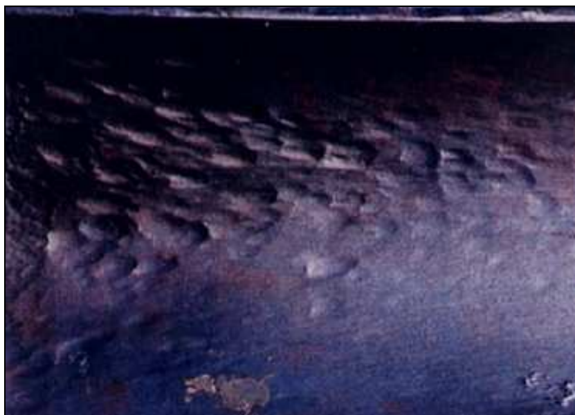
Figura 4.4- Superfície corroída em tubulação com escoamento turbulento (ZAPELINI, 1996).
