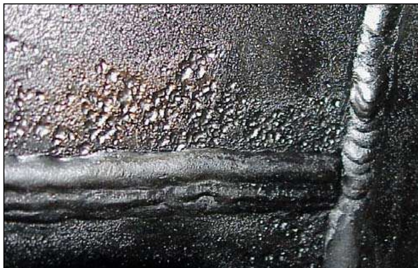
Figura 4.5- Corrosão alveolar por condensação no costado da torre (BERNARDES, 2005).
