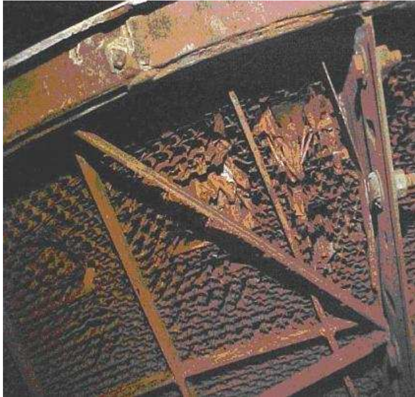
Figura 6.11- Chapas de aço corrugadas não revestidas do pré-aquecedor atacadas pelo ácido sulfúrico (SCHULTZ, 2003).
