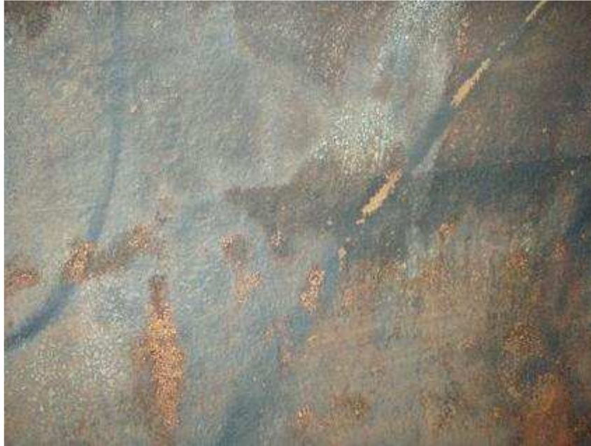
Figura 6.6- Detalhe do revestimento de Nb_2O_5 com regiões do substrato de aço oxidadas, inspeção em 31/10/2007 (REDUC, 2007b).
