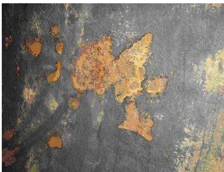
Figura 6.8- Substrato de aço ao carbono exposto e corroído devido à falha do revestimento niobizado, inspeção em 31/10/07 (REDUC, 2007b).
