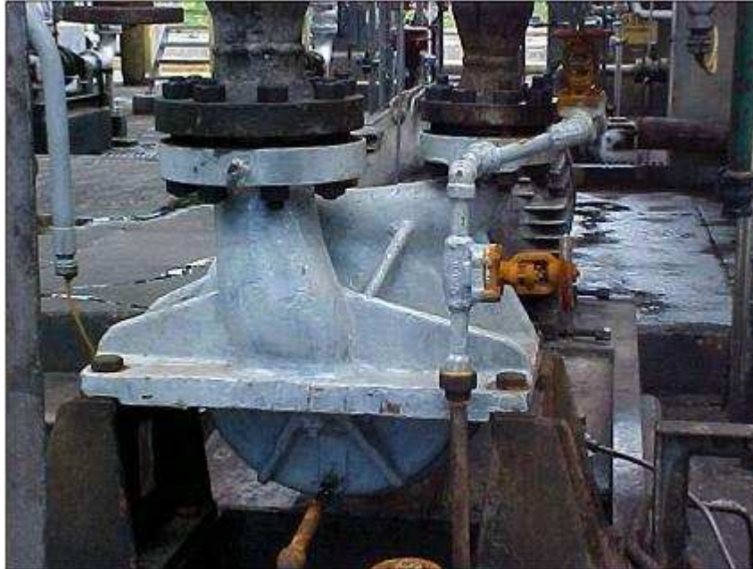
Figura 6.28- Bomba logo após a pintura com tinta epóxi pigmentada com \text{Nb}_2\text{O}_5 , inspeção em outubro de 2001 (SHULTZ, 2003).
