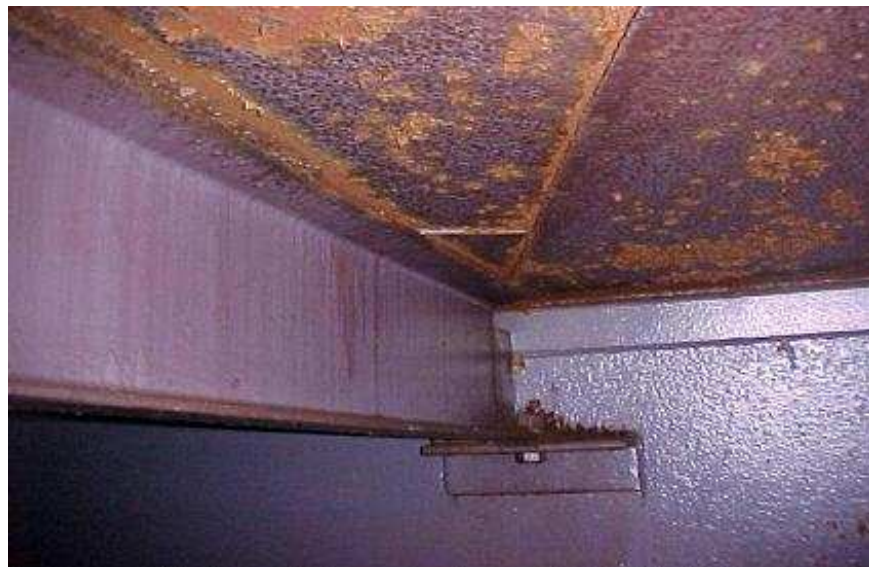
Figura 6.20- Corrosão por frestas generalizada entre a chaparia e as vigas de sustentação do tanque (SCHULTZ, 2003).
