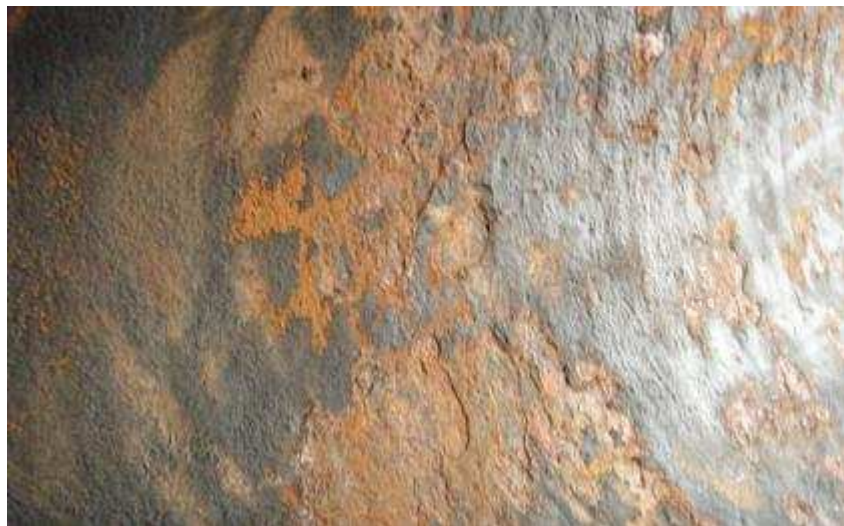
Figura 6.10- Descascamento do revestimento expondo o aço à corrosão, inspeção em 31/10/2007 (REDUC, 2007b).
