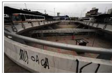
Pichações estão presentes em toda a estrutura do terminal de ônibus
