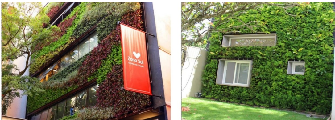
Figura 61 – Aplicações externa Fonte: Ecotelhado (2013)
