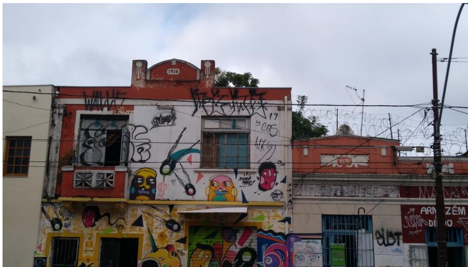
Grafitos, pichações e tags em prédio na Rua João Alfredo.
