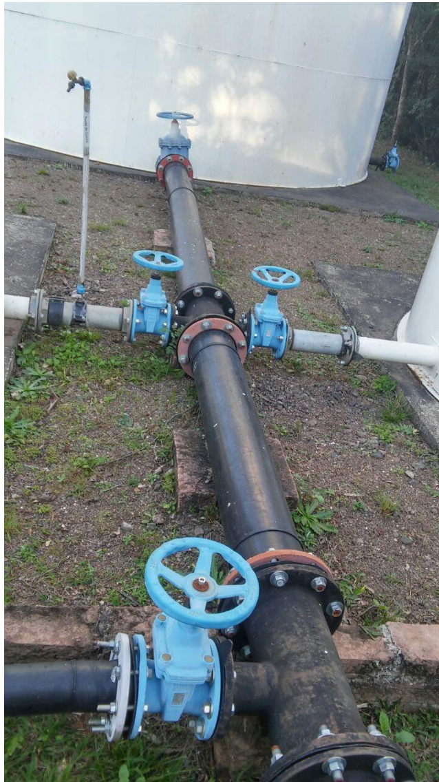
Figura 30 - Rede de manobra de volumes em PEAD em um dos poços de captação construídos pela Autarquia para complementar o sistema recebido da CORSAN
