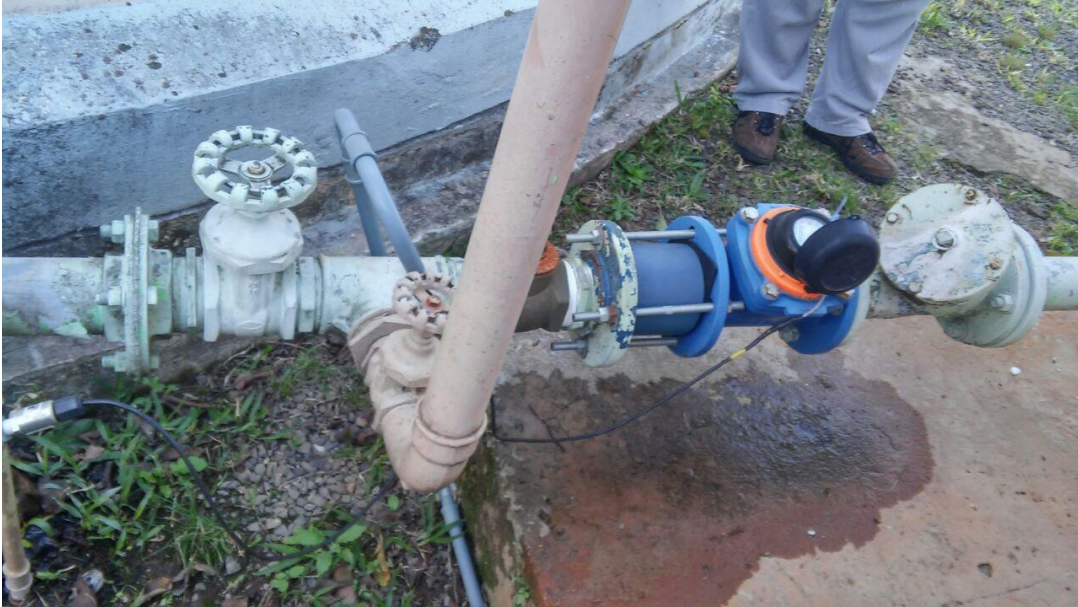
Figura 28 - Macro medidor em um dos poços de captação apresentando um pequeno vazamento em uma das conexões
