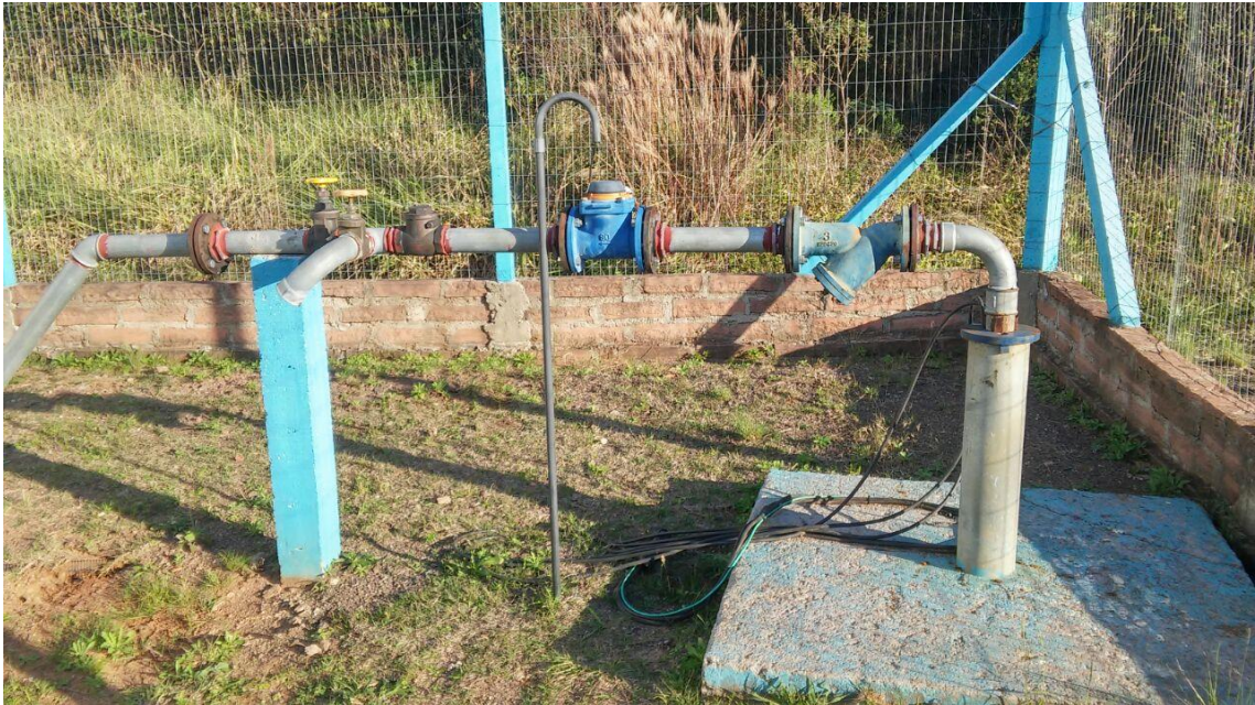
Figura 32 - Poço de captação em detalhes
