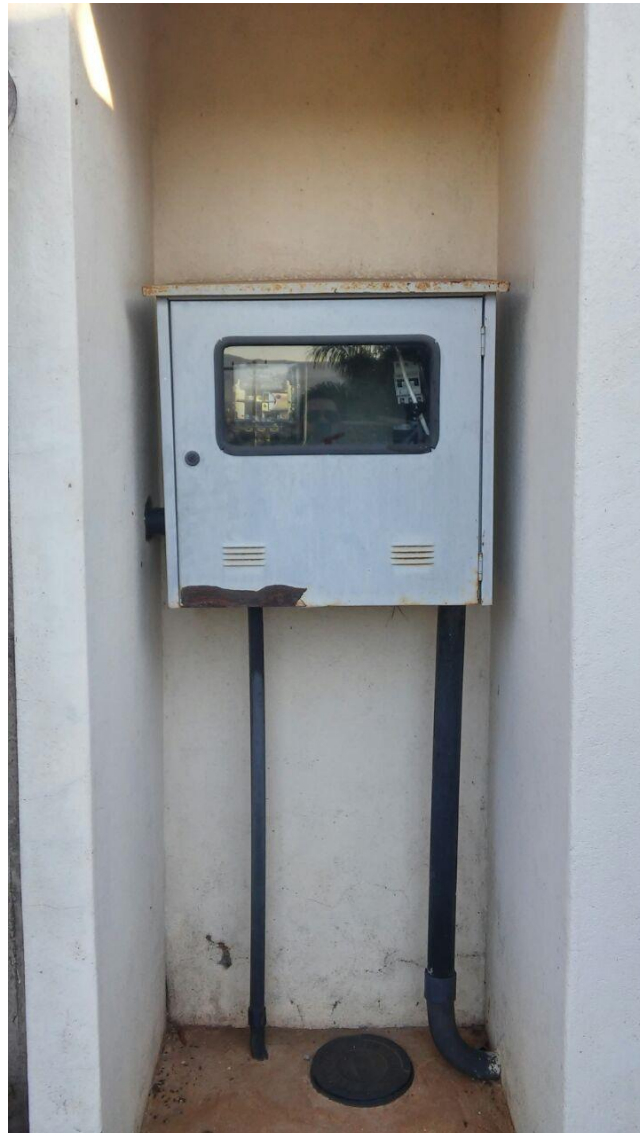
Figura 19 – Foto mostrando o medidor de energia elétrica, que é item existente em todos os poços de captação ou unidade de bombeamento da Autarquia
