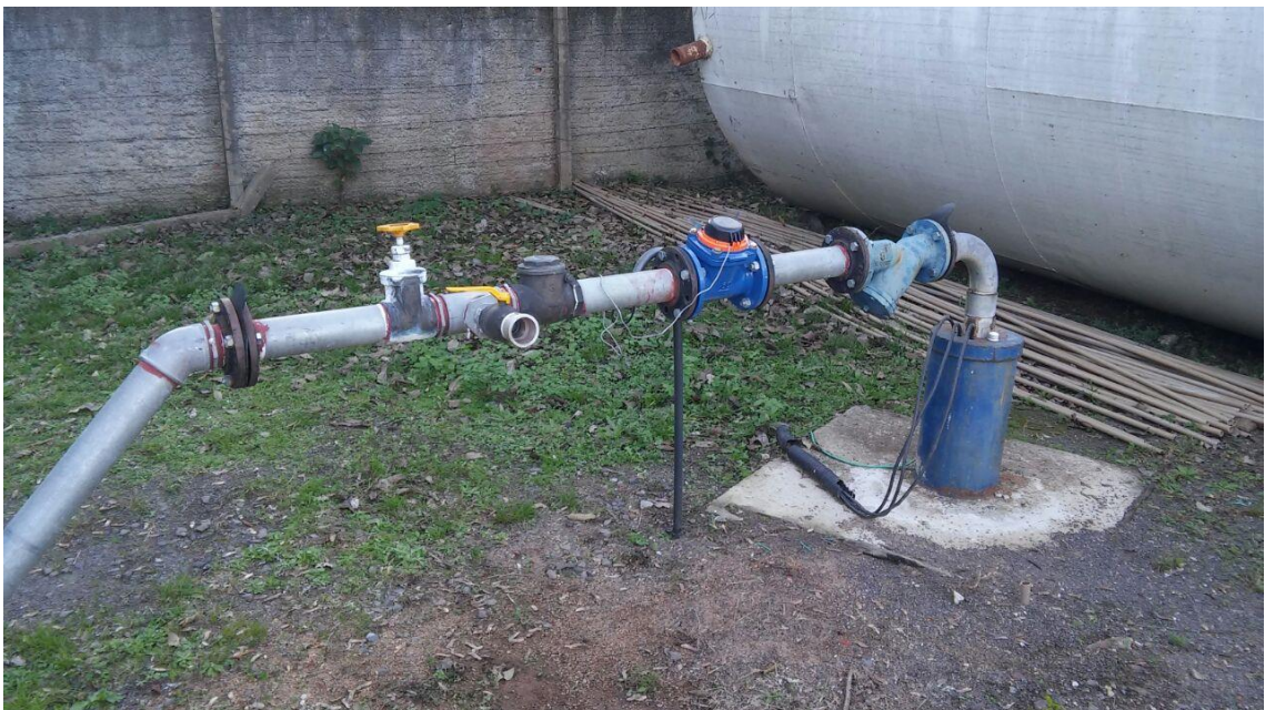
Figura 24 - Foto de um poço de captação que mostra o macro medidor e as conexões de ligação do conjunto de tubulação de adução de água bruta
