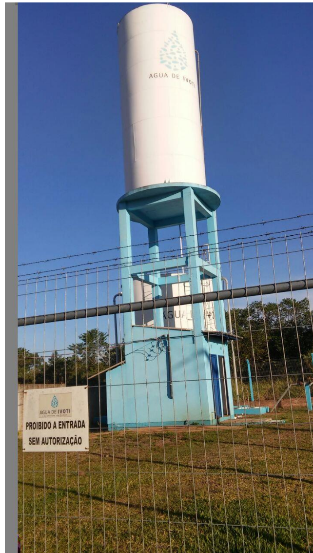
Figura 22 - Unidade com poço de captação, casa de bombas, reservatório apoiado e reservatório elevado
