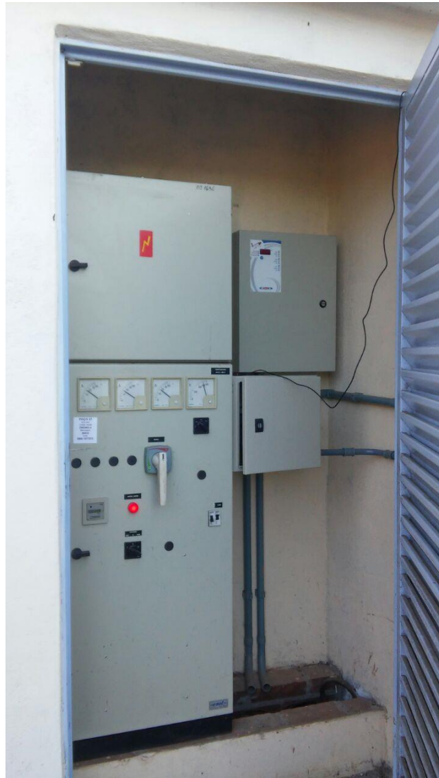
Figura 18 – Foto com o detalhe do interior de cada casa de controles existente em cada um dos 26 poços de captação do município de Ivoti/RS
