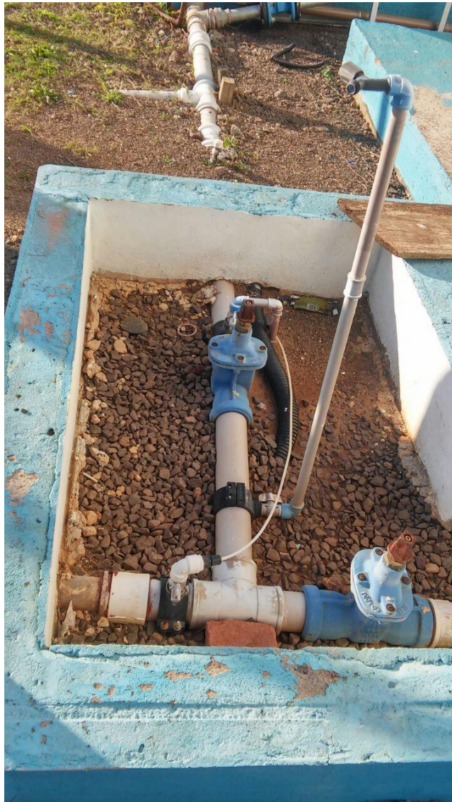
Figura 31 - Detalhe do dosador de cloro chegando na tubulação que levará a água até o reservatório
