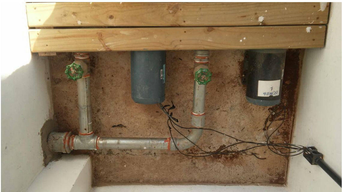
Figura 21 - Par de bombas de manobra de volumes de armazenamento, onde um reservatório semienterrado abastece um reservatório elevado
