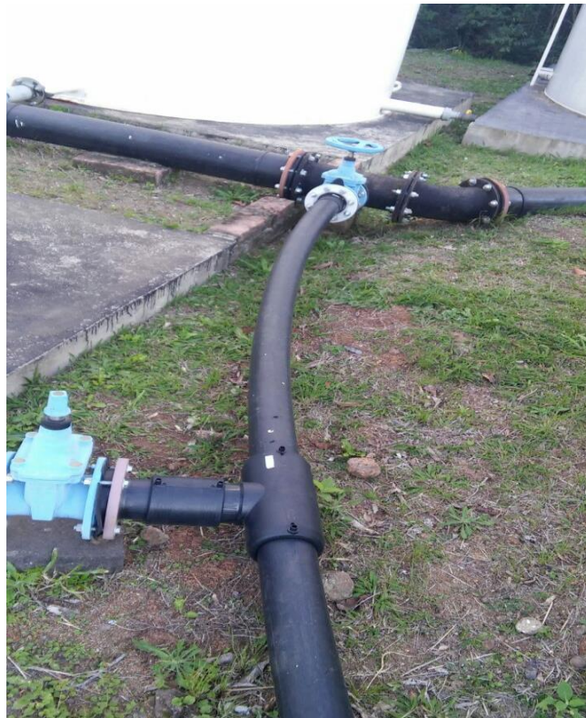
Figura 29 - Rede de manobra de volumes em PEAD em um dos poços de captação construídos pela Autarquia para complementar o sistema recebido da CORSAN
