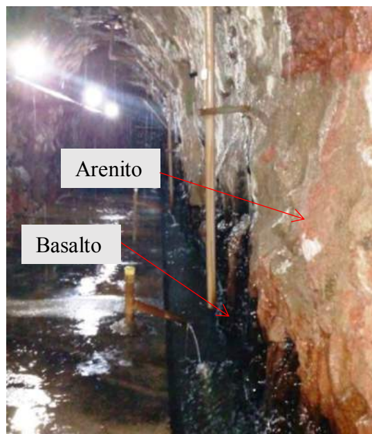
Figura 36 – Infiltrações no túnel em rocha na ombreira direita
