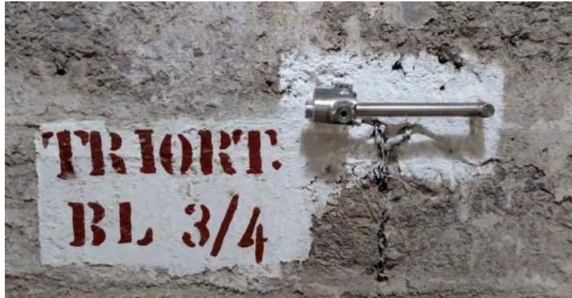
Figura 28 – MTJ instalado entre os blocos B3 e B4 da UHE Dona Francisca
