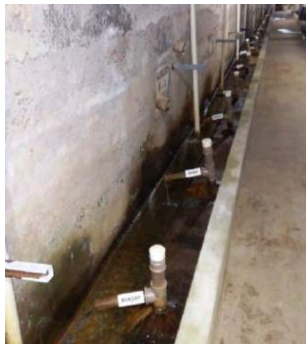
Figura 35 – Drenos de piso ao longo da galeria de drenagem
