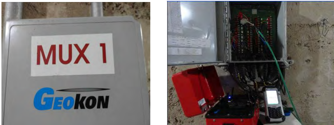
Figura 25 – Detalhe caixa coletora “MUX” e “Readout”. (Fonte: MPI da UHE Dona Francisca - CEEE-GT, 2016)
