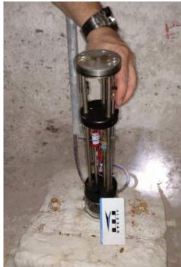
Figura 29 – Cabeça do EM-S6-03 instalado no bloco B25 da UHE Dona Francisca
