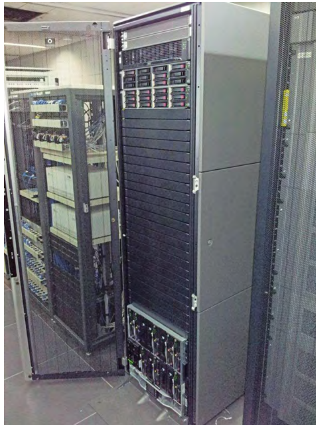
Figura 12.8 - Nuvem UFRGS: unidade de armazenamento e servidores
