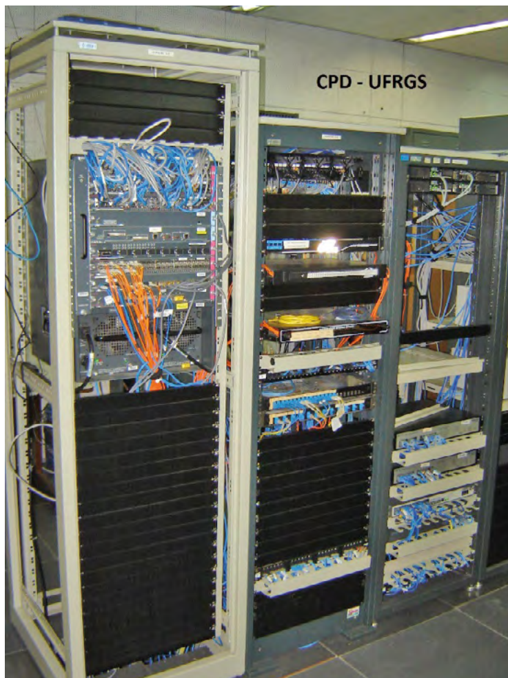
Figura 12.3 - Cisco 6500 instalado no CPD
