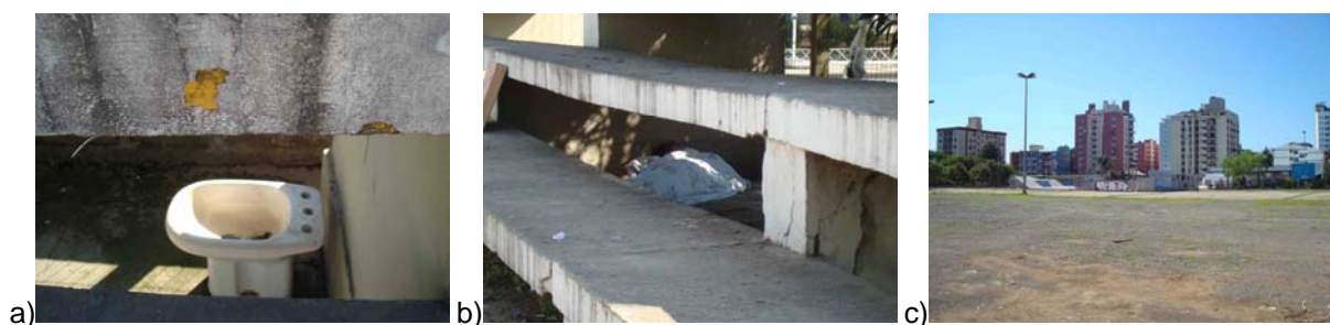
Figura 4.18 – Falta de manutenção no Largo Rui Porto: a) Lixo depositado embaixo da arquibancada; b) Mendigos dormem embaixo das arquibancadas; c) Piso de areia e brita, fica completamente enlameado em dias de chuva. Fonte: autora, 2008.
