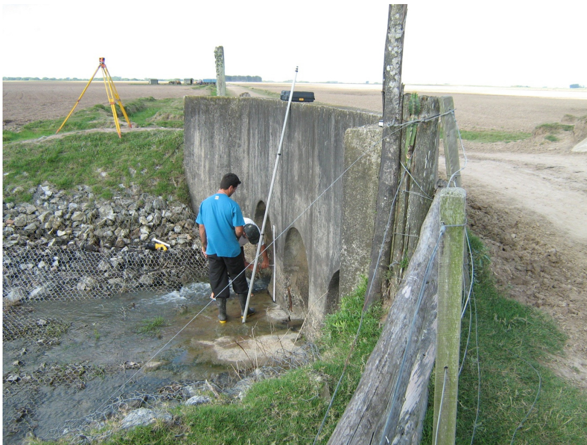
Figura 31 – Colocação de réguas de medição na seção de jusante de uma estrutura de controle
