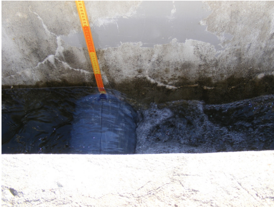
Figura 39 – Tubo e escala colocados no canal trapezoidal superior do NUHCC
