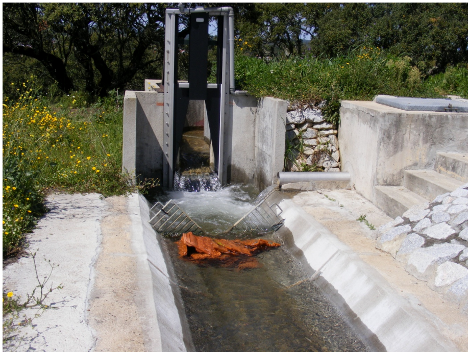
Figura 40 – Amortecimento das ondas provocadas pela over shot gate
