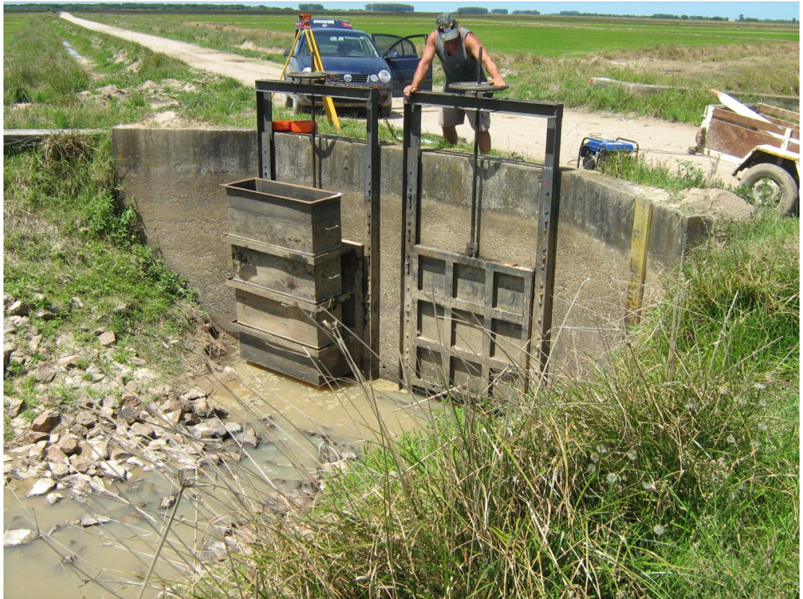
Figura 32 – Estrutura de controle do sistema de irrigação do arroio Chasqueiro, mostrando o volante e o parafuso sem fim. A comporta da esquerda mostra um vertedor tulipa acoplado, responsável pela segurança do canal.
