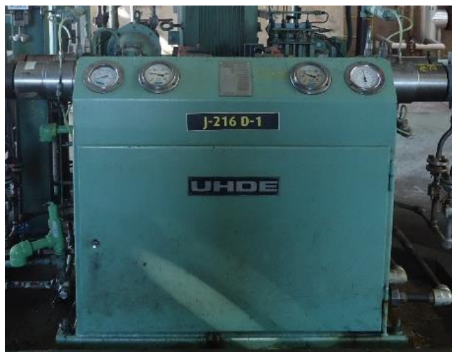
Figura 4.1 - Bomba de peróxido do fabricante UHDE
