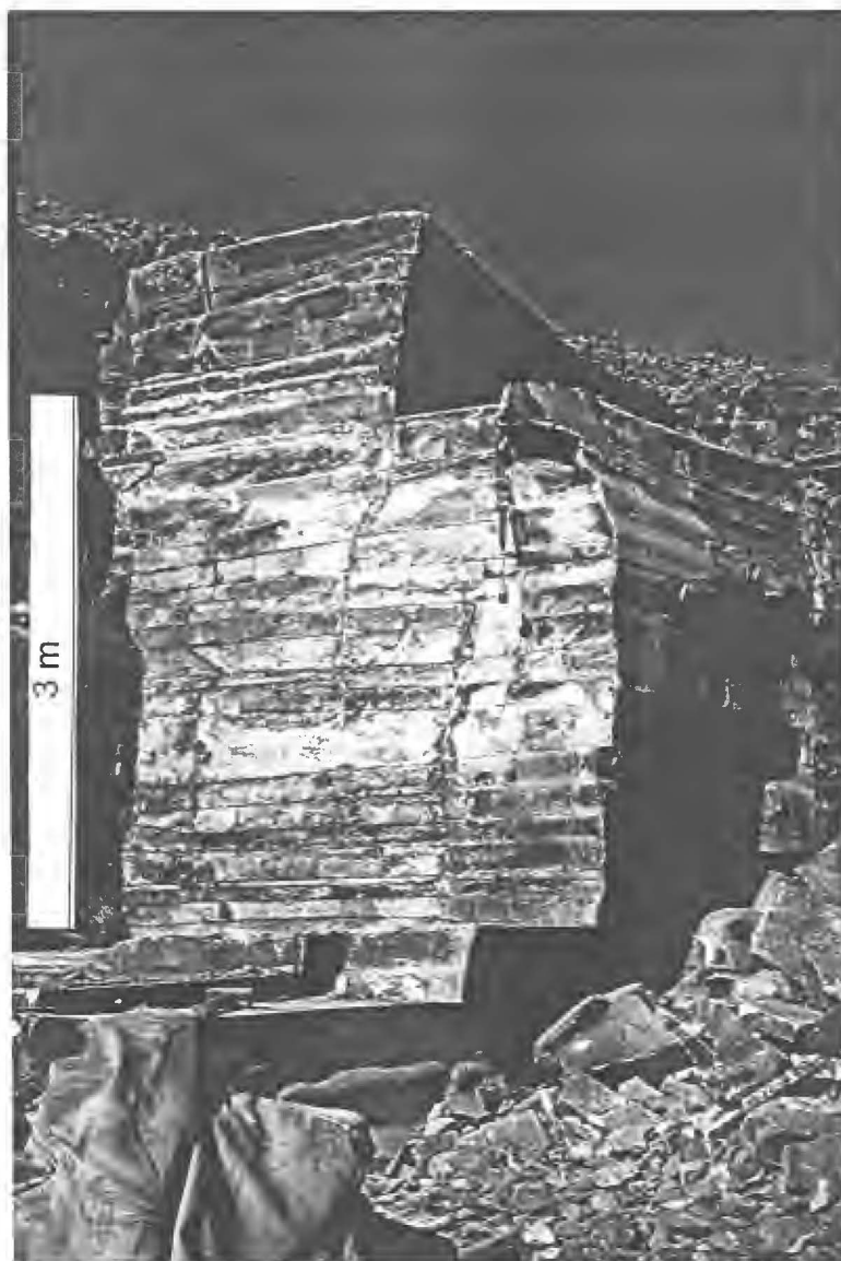
Figura 5.11 – Padrão de fraturas anastomosadas do nível dacítico superior (DS) da região de Salto do Jacuí
