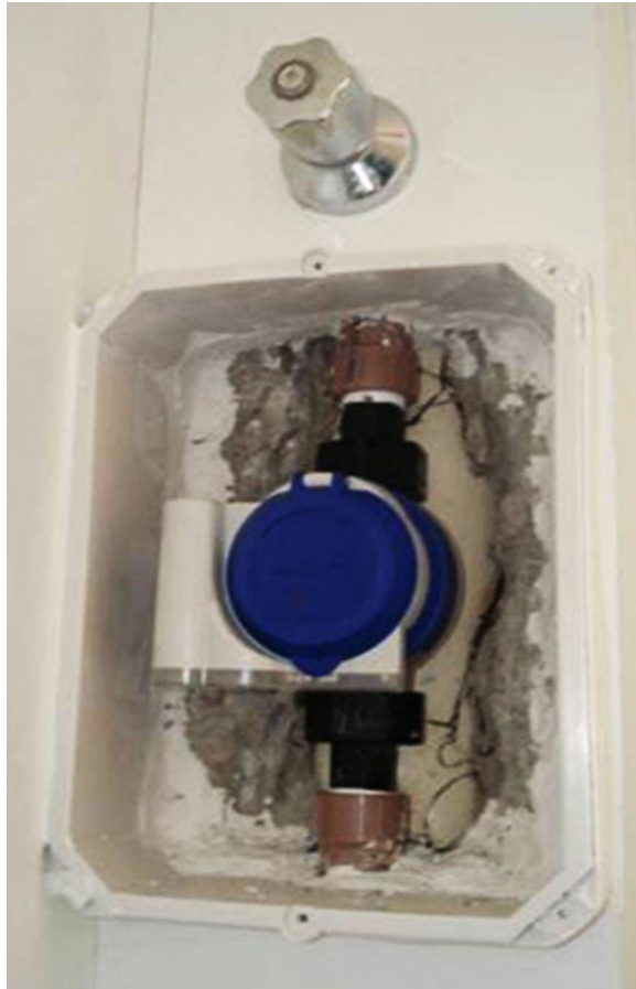
Figura 17 - Hidrômetro instalado no interior da parede abaixo do registro(Fonte: TGA, 2018)
