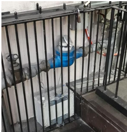
Figura 10 - Sistema hidrômetro com wireless GPRS do DMAE, em ramal predial principal (Fonte: autor)
