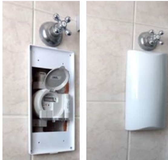
Figura 16 - Hidrômetro instalado no interior da parede abaixo do registro (Fonte: ETICAIND, 2018)
