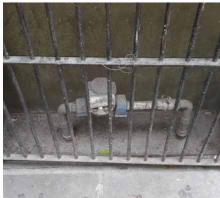
Figura 12 - Hidrômetro do DMAE com sistema via rádio, para locais de difícil acesso (Fonte: autor)
