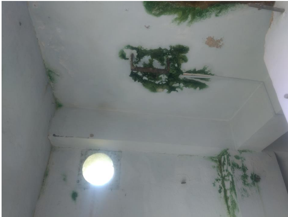
Figura 11 - Infiltrações na sede do MCAR
