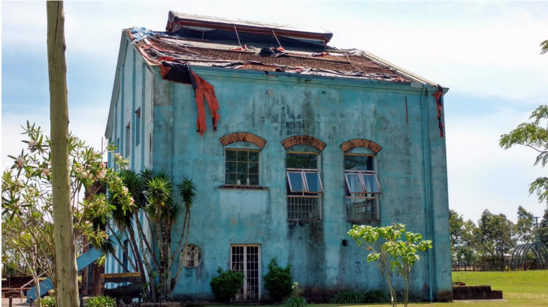
Figura 10 - Lona no Telhado na sede do MCAR
