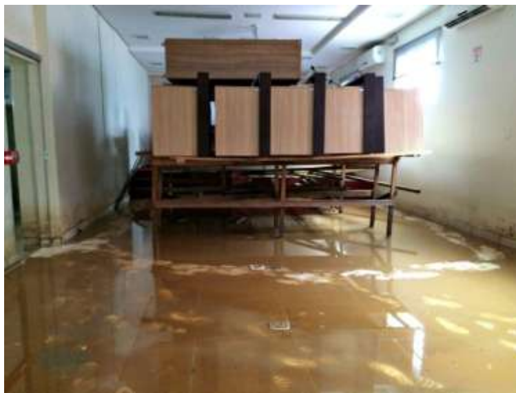
Figura 25 – CMRB atingida pela alagação em 5 de março
