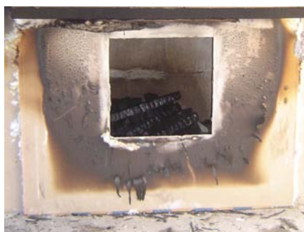
Figura 52: Integridade da chapa de gesso acartonado resistente ao fogo após a queima.
