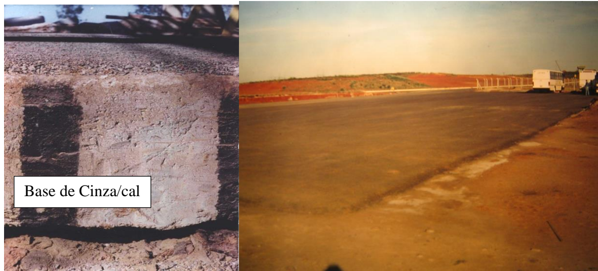
Figura 12 - Pavimento de base de cinza volante e cal hidratada no Polo Petroquímico de Triunfo, 6 km – CICASOL. Fonte: Autor (2017)
