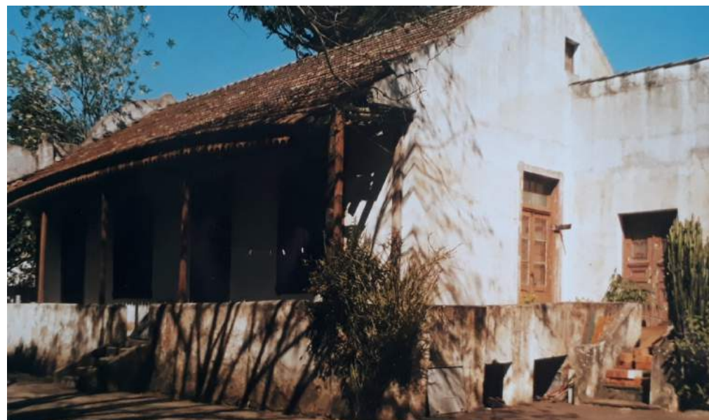
Descaracterização das muretas originais e acréscimos de escadas e edícula anexa (fonte: Acervo EPAHC)
