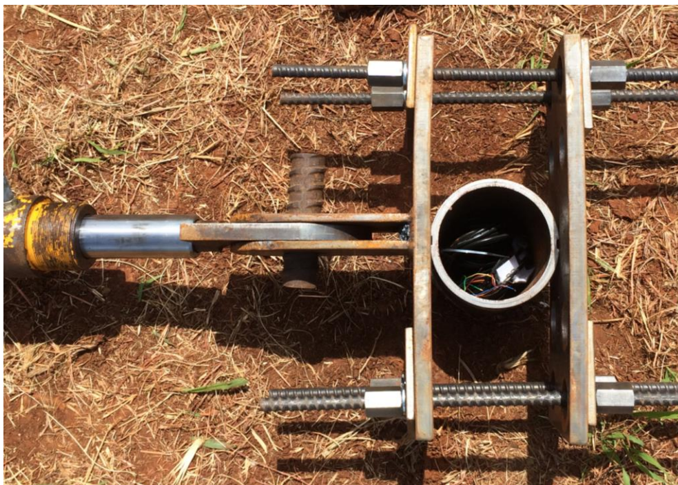
Figura 50 - Rótula de ligação entre sistema de aplicação de carga e estaca (superior)
