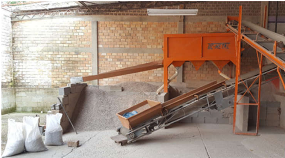
Figura 10 – Instalações e equipamentos de processamento do RCD da fonte 2
