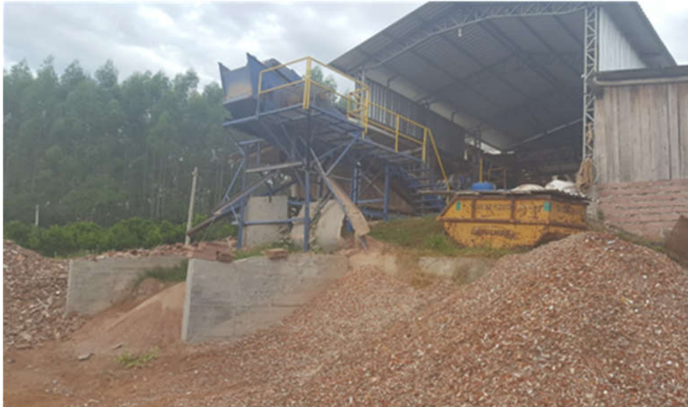
Figura 9 – Instalações e equipamentos de processamento do RCD da fonte1
