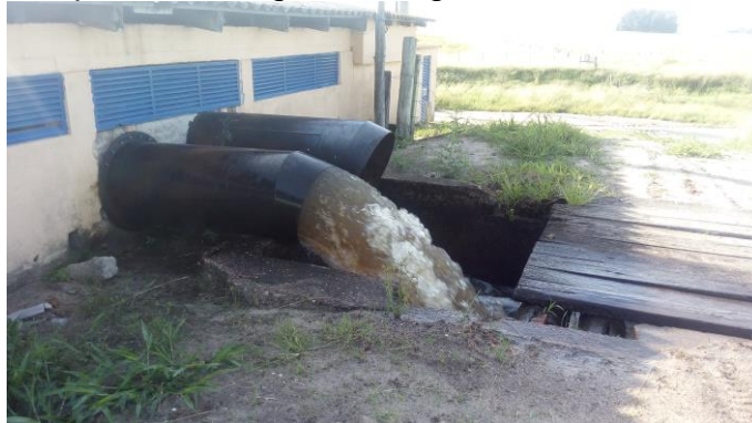
Figura 15 – bomba da puxada da água da Laguna. Fazenda Santa Rita / RS
