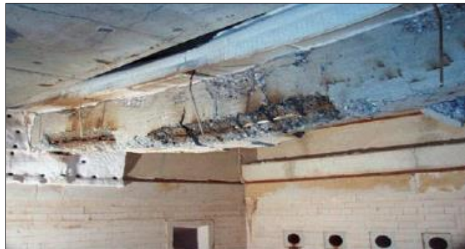
Figura 3.20: spalling em viga de concreto.
